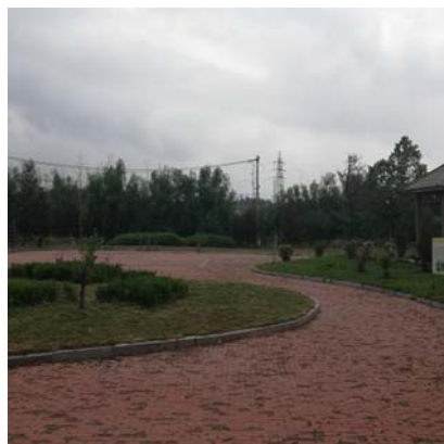
临港区佳赛园小游园路面破损
