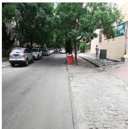
皇冠西路人行道破损
