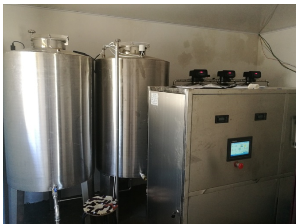
环翠区张村镇刘家疃村净水设备
